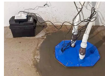
排水泵的备用电池
